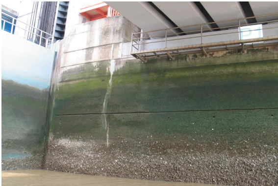
&lt;언주 균열 및 백태&gt;
