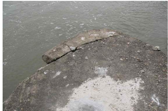
&lt;언주 두부 콘크리트 파손&gt;
